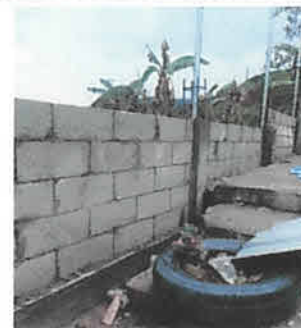
Foto 6: fundición de columnas con tubo para colocación de malla para extensión de la altura del muro perimetral.
